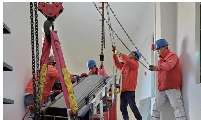
“注意吊装起落位置!注意安全距离!”12月15日上午,随着变压器就位,供电公司工程营销部圆满完成徐圩新区1#可再生能源站增容项目设备吊装工作,为项目可靠用电奠定基础。(郑皓)
